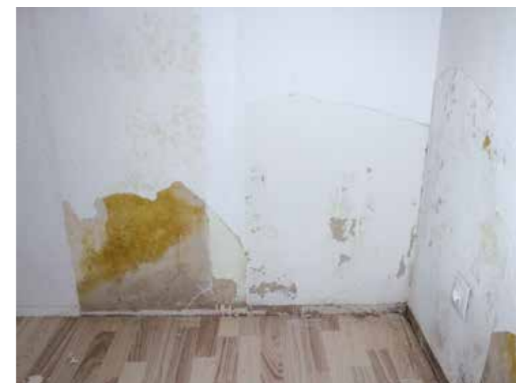
Schimmel und eine nasse Wand in der Wohnung
