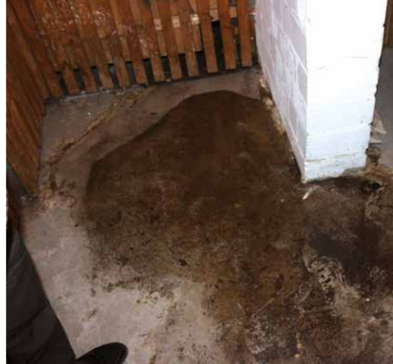
Feuchter Kellerraum mit Kabelprovisorium
